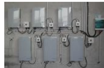
Onduleurs EARL. SOMMANT, Lamargelle (21) Source ADEME
